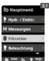
FILTER PUMP Filtrationssteuerung ⑦ und ⑧
