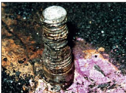
Ankerschraube (1.4016) nach der Demontage, starke Querschnittsminderung durch Korrosion
